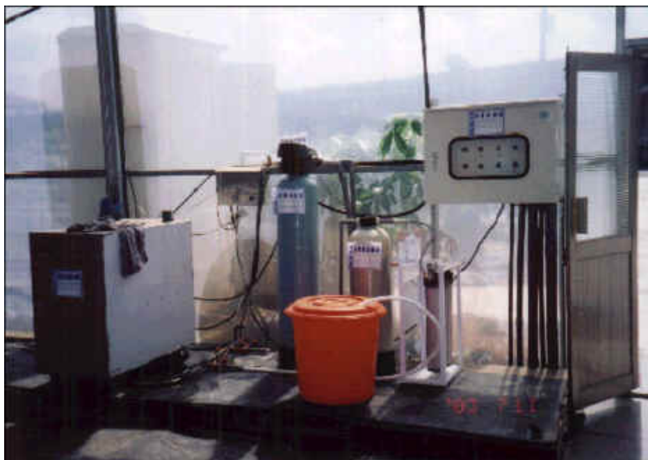
照片 2 善化公司園藝設施高壓噴霧降溫系統作業主機
