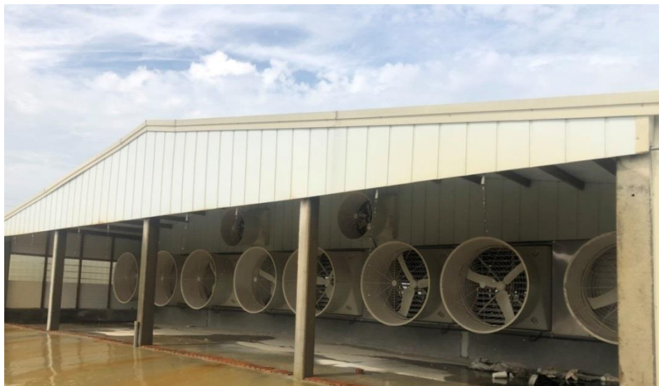
圖 15、禽舍通風設備
